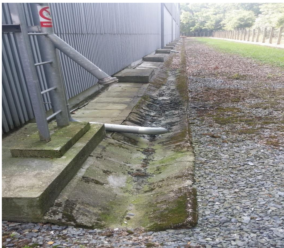
Obr. 2 Poškozené odvodňovací úžlabí
