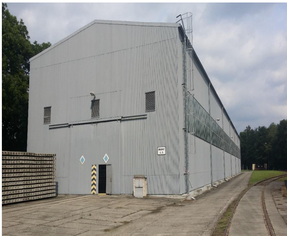
Obr. 1 Objekt skladu č.5 s poškozeným odvodňovacím úžlabím
